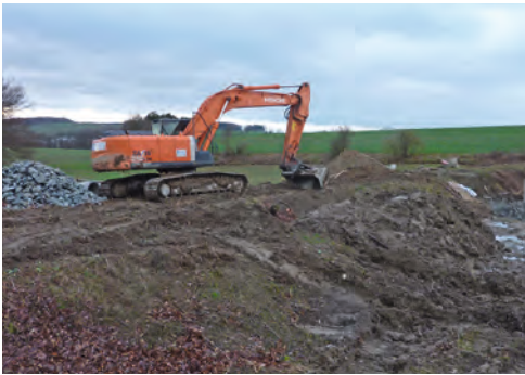
Abb. 30: Bei der Revitalisierung oder Anlage von staunassen Bereichen kommt auch intensiv große Technik zum Einsatz.
